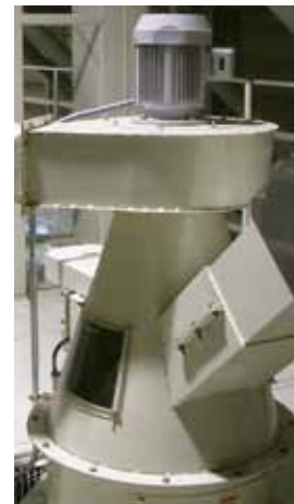
■集塵機 (乾燥機上部)
